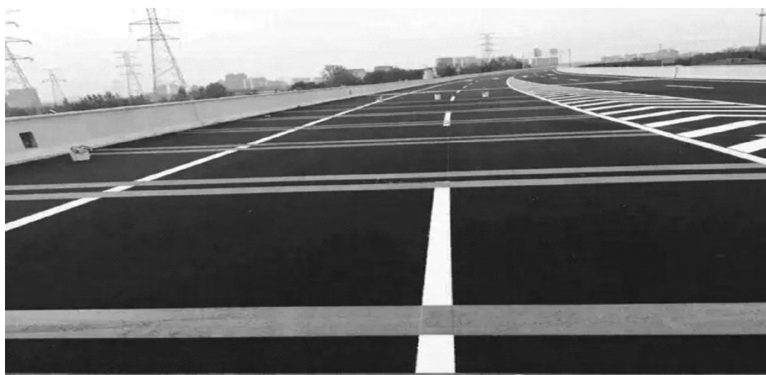
图 2 山东青龙高速匝道合流处警示线
